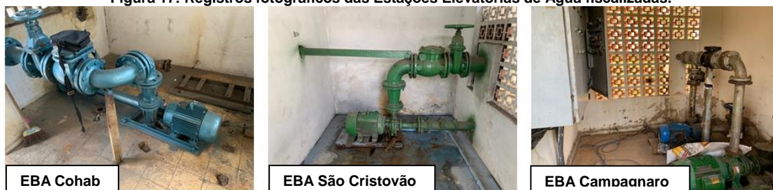
Figura 17: Registros fotográficos das Estações Elevatórias de Água fiscalizadas.
