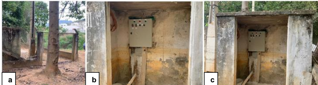
Figura 20: Registros fotográficos da Estação de bombeamento de esgoto Sirtoli: a) Vista da entrada da EBE; b) Painel elétrico; c) Estrutura que abriga painel elétrico.
