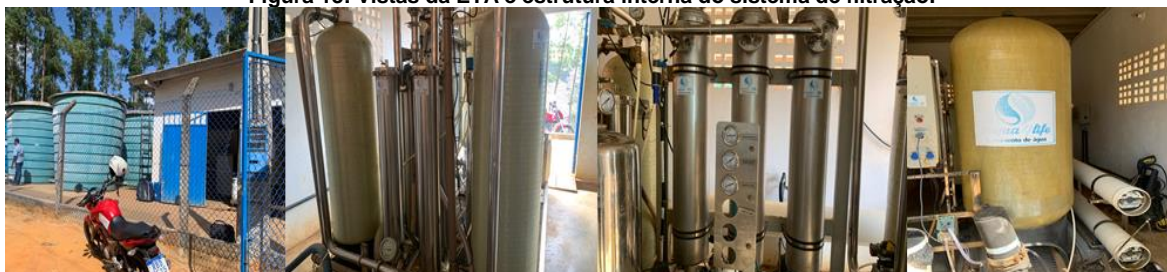
Figura 13: Vistas da ETA e estrutura interna do sistema de filtração.
