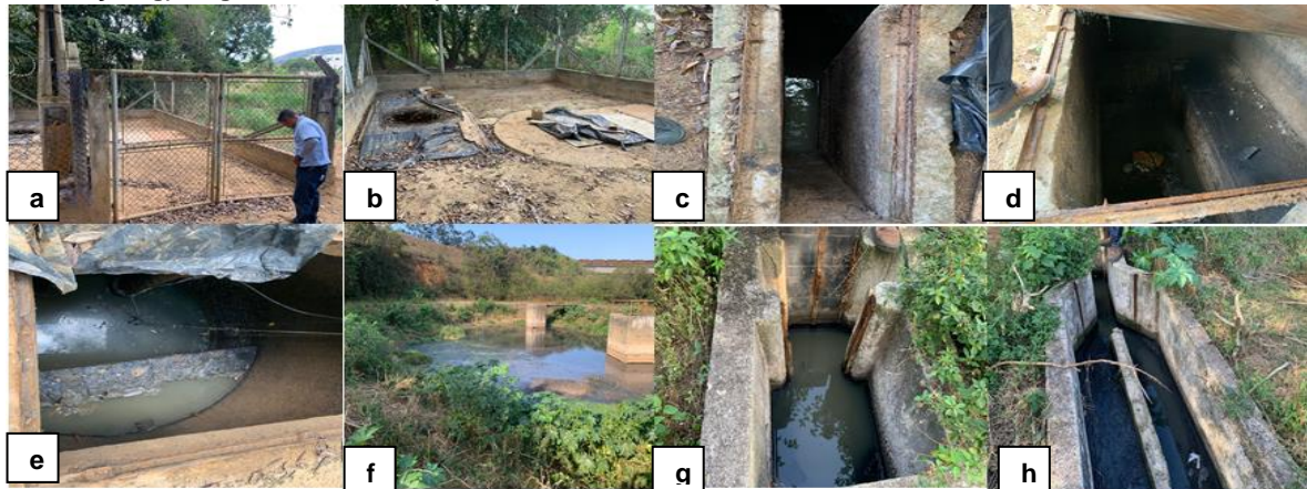
Figura 19: Registros fotográficos da Estação de tratamento de Esgoto Sirtoli: a) Vista da entrada da ETE; b) Vista Pátio da ETE; c) Entrada do efluente; d) Caixa desarenadora; e) Poço de sucção e grade de retenção; f) Lagoa de decantação; g) Chegada do efluente; h) Caixa desarenadora.
