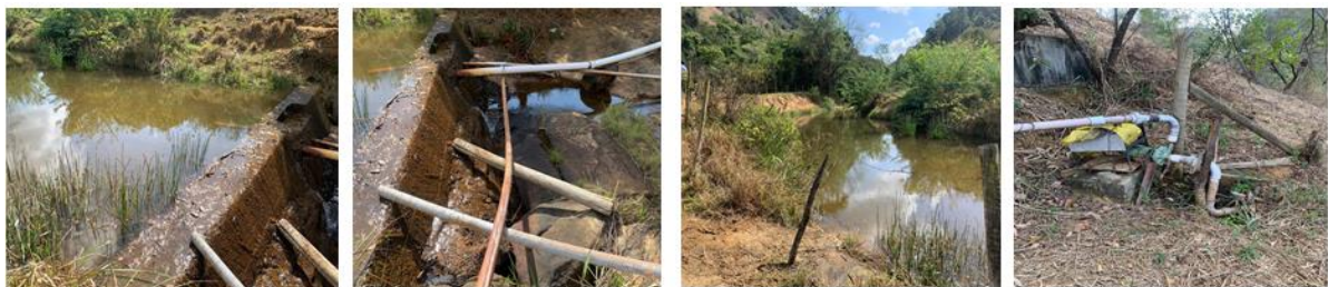
Figura 6: Registro Fotográfico da captação superficial Córrego Santa Luzia.
