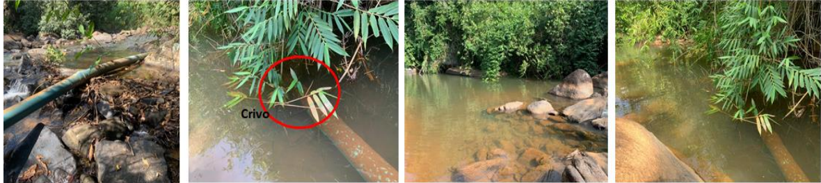
Figura 7: Registro fotográfico da captação superficial Piraque-Açu.
