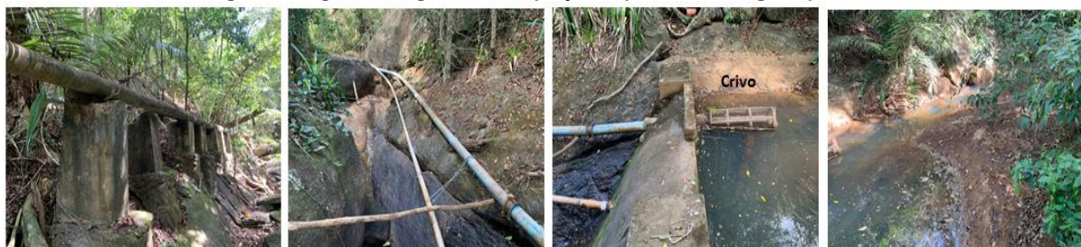
Figura 8: Registro fotográfico da captação superficial Córrego Sapateiro.
