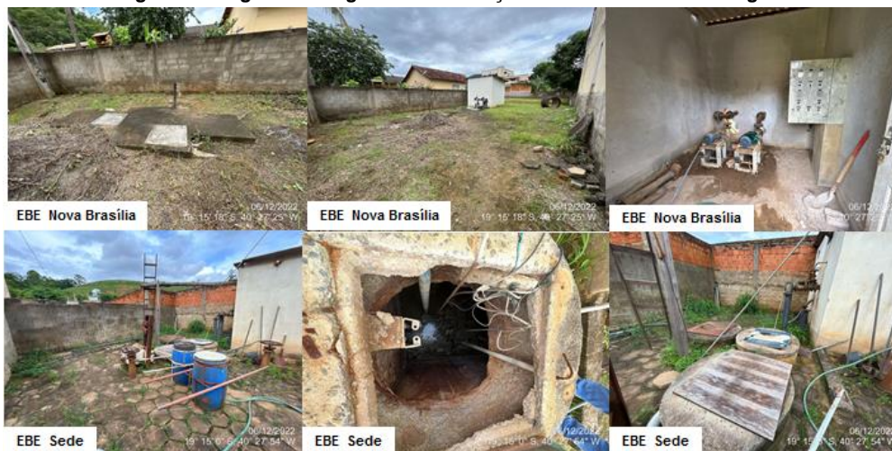
Figura 24: Registros fotográficos da Estação de bombeamento de esgoto.
