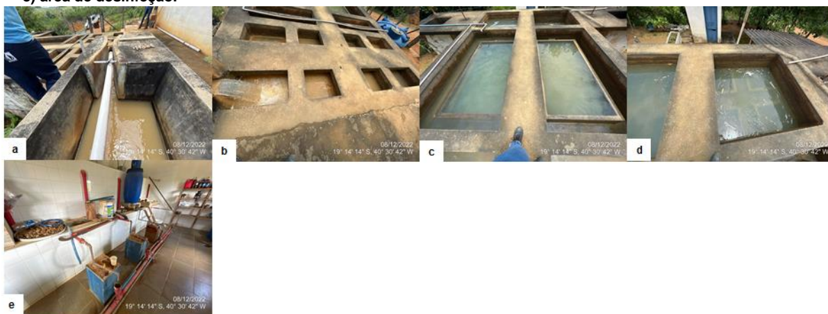
Figura 16: Vistas da ETA Moacir Ávidos: a) Calha Parshall; b) Floculadores; c) Decantadores; d) Filtros; e) área de desinfecção.
