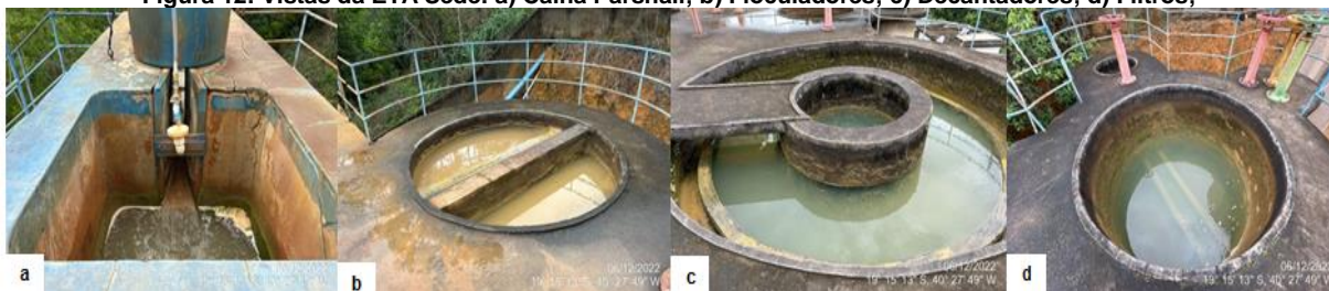
Figura 12: Vistas da ETA Sede: a) Calha Parshall; b) Flocladores; c) Decantadores; d) Filtros;
