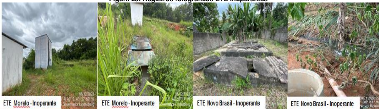
Figura 23: Registros fotográficos ETE inoperantes
