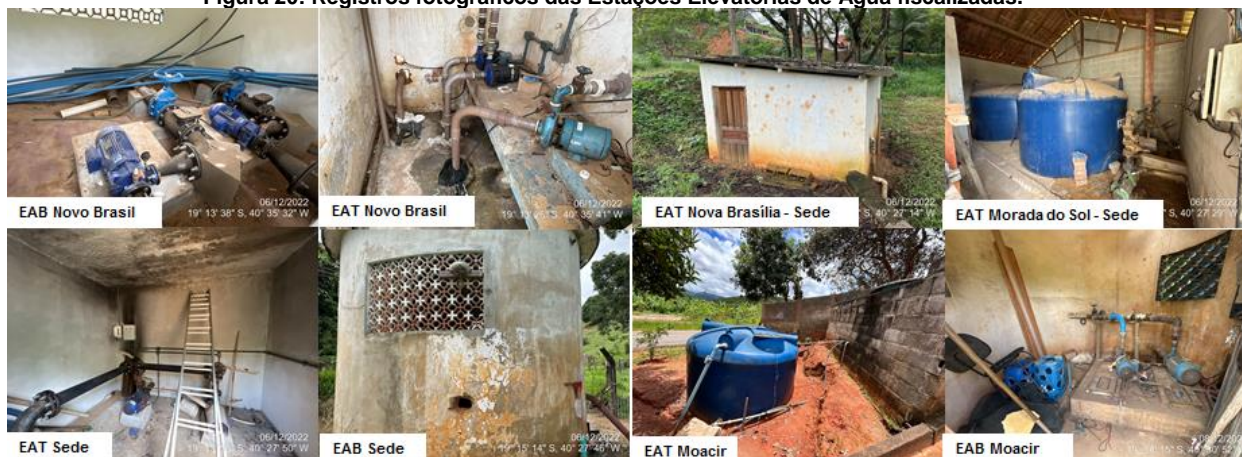
Figura 20: Registros fotográficos das Estações Elevatórias de Água fiscalizadas.
