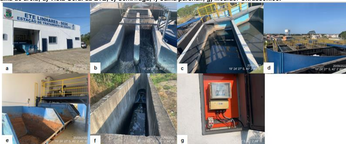
Figura 33: Registros fotográficos ETE Aviso: a) Vista da entrada da ETE; b) Tratamento preliminar por gradeamento; c) Caixa de areia; d) Vista Geral da ETE; e) Centrifuga; f) Calha parshall; g) Medidor Ultrassônico.
