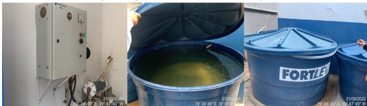
Figura 28: Registro das estruturas do sistema de cloração
