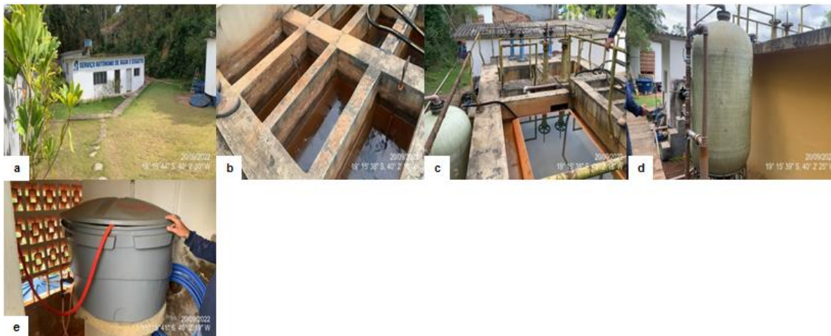
Figura 18: a) Vista Frontal da ETA; b) Floculadores (inoperante); c) Decantador (inoperante); e) área de desinfecção.
