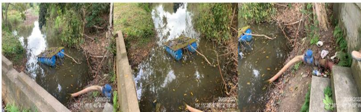
Figura 10: Registro Fotográfico da captação superficial Córrego Farias.
