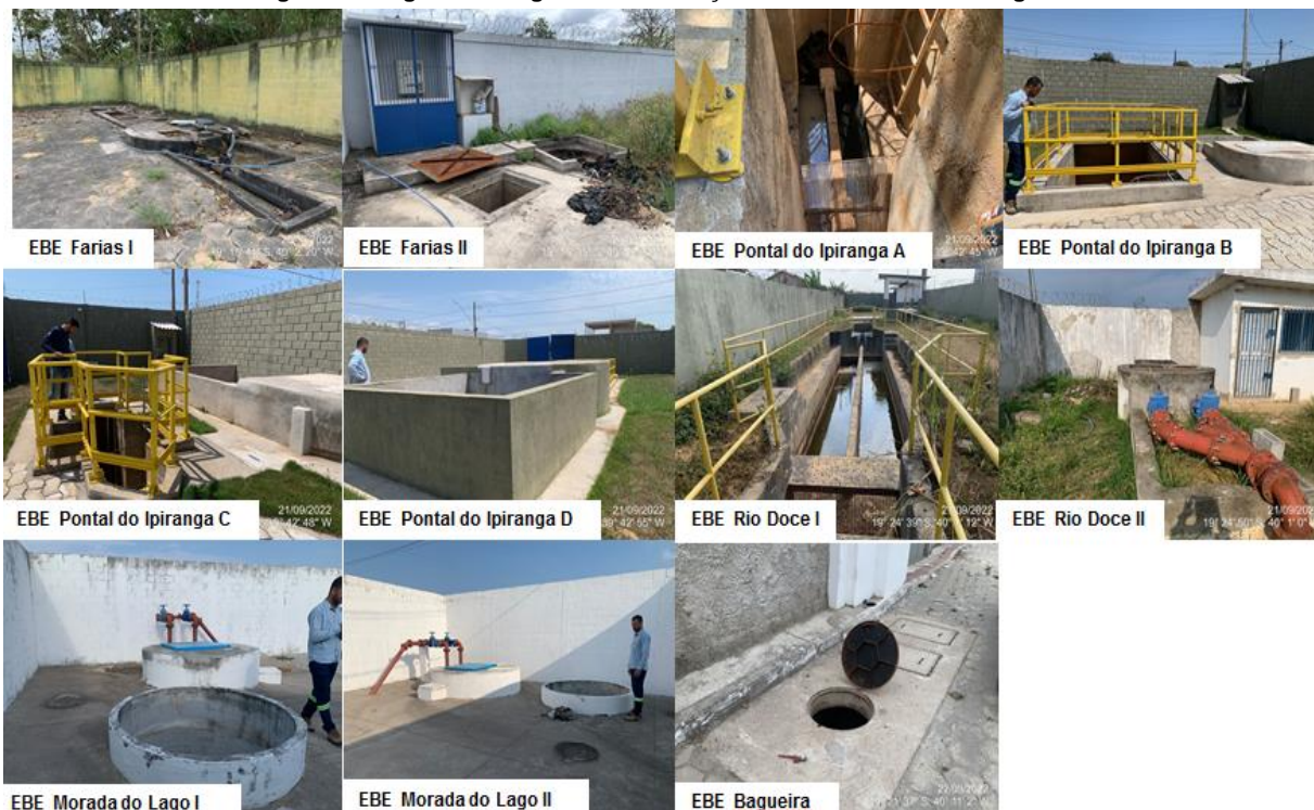
Figura 41: Registros fotográficos da Estação de bombeamento de esgoto.
