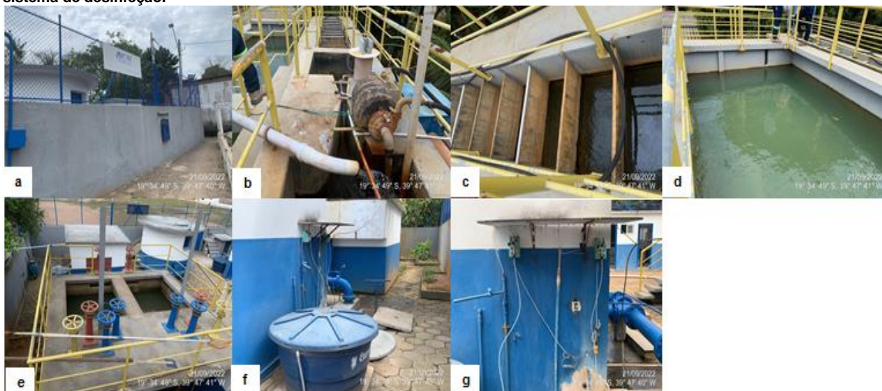
Figura 25: a) Vista Frontal da ETA; b) Calha parshall; c) Floculadores; d) Decantador e) Filtros; f) área de desinfecção; g) sistema de desinfecção.
