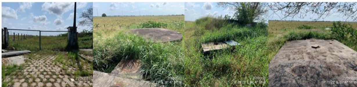
Figura 37 Registros fotográficos da Estação de tratamento de Esgoto Agrovila.
