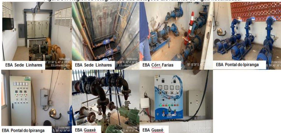
Figura 31: Registros fotográficos das Estações Elevatórias de Água fiscalizadas.
