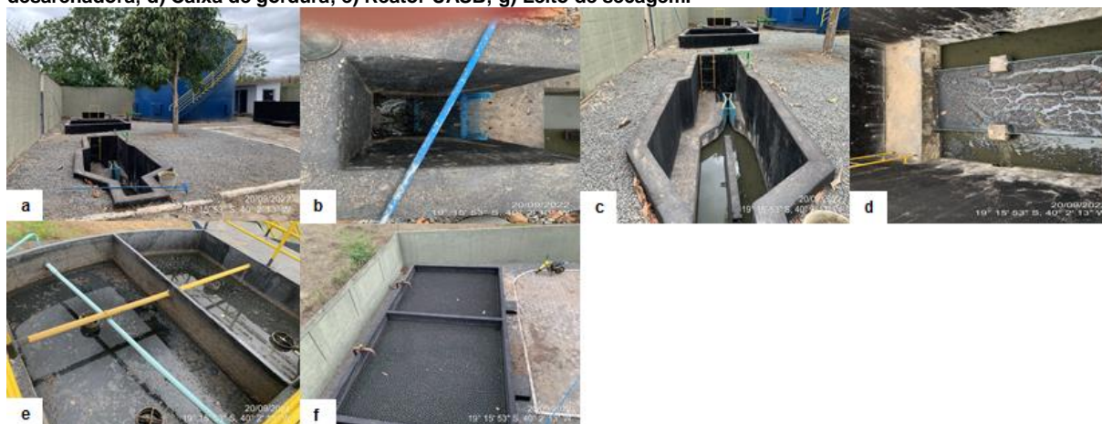
Figura 36: Registros fotográficos ETE Farias: a) Vista Geral da ETE; b) Tratamento primário por gradeamento; c) Caixa desarenadora; d) Caixa de gordura; e) Reator UASB; g) Leito de secagem.
