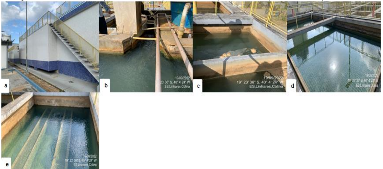
Figura 16: Vistas da ETA III: a) Entrada da ETA; b) Calha Parshall; c) Floculadores; d) Decantadores; e) Filtros.
