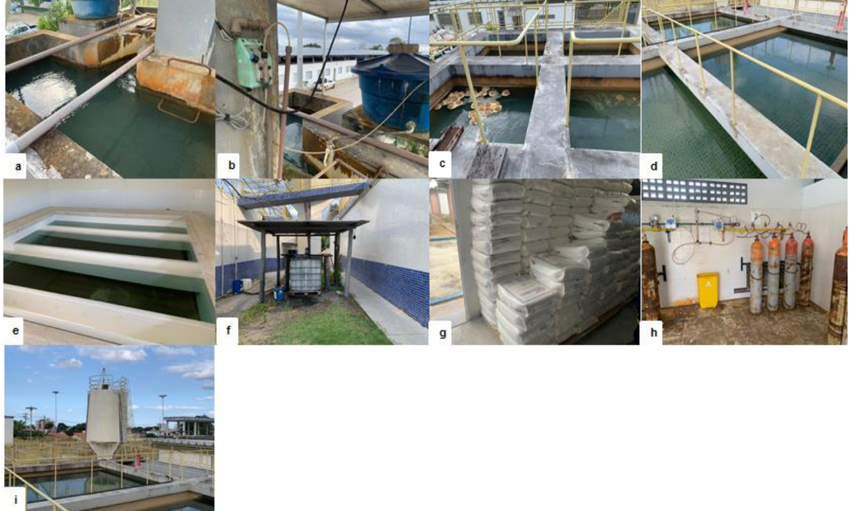
Figura 15: Vistas da ETA II: a) Calha Parshall; b) Sistema dosador de coagulante; c) Floculadores; d) Decantadores; e) Filtros Classificadores; f) Armazenamento de carvão ativado; g) Armazenamento de produtos químicos; h) Sistema de cloro a gás; i) Reservatório de sulfato de alumínio.
