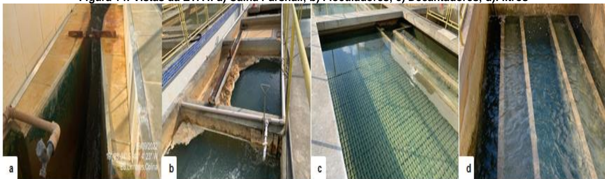
Figura 14: Vistas da ETA I: a) Calha Parshall; b) Floculadores; c) Decantadores; d) Filtros
