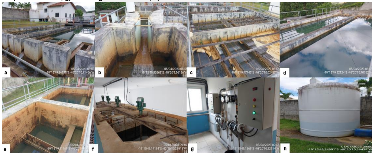
Figura 14: Vistas da ETA 2 Sede: a) vista geral da eta b) calha parshall; c) floculadores; d) decantadores; e) filtros; f) tanques de mistura; g) sistema gerador de cloro; h) Reservatório de sulfato.
