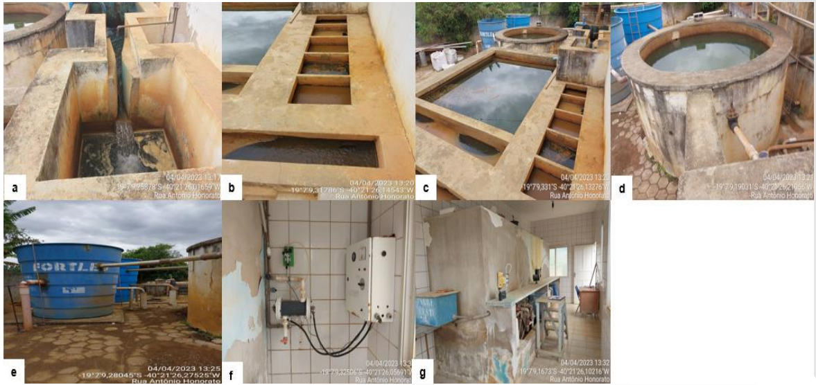
Figura 16: Vistas da ETA São Jorge de Tiradentes: a) calha parshall; b) floculadores; c) decantador 1; d) decantador 2; e) filtros; f) sistema gerador de cloro; g) tanques de contato
