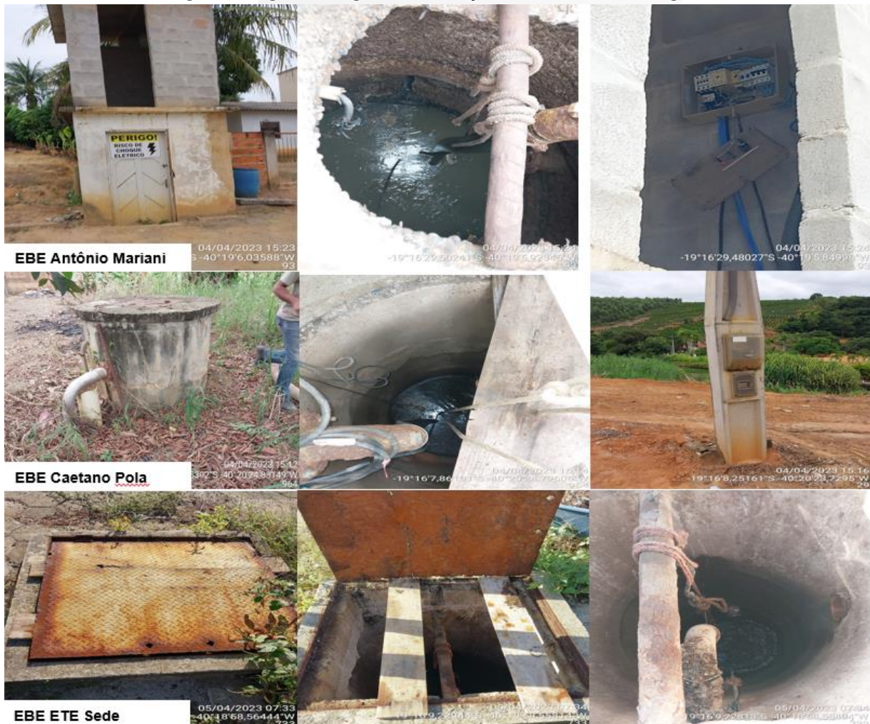
Figura 25: Registros fotográficos da Estação de bombeamento de esgoto.
