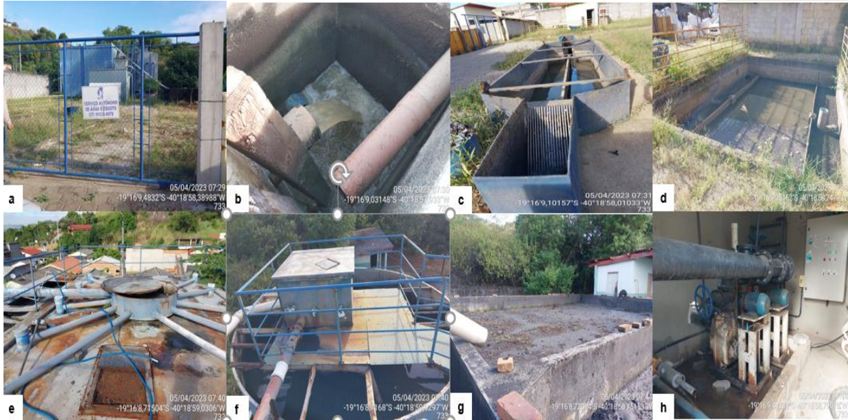
Figura 23: Registros fotográficos Ete Sede: a) Vista da entrada da Ete; b) Chegada do esgoto; c) Gradeamento e caixa de areia; d) Caixa de Gordura; e) Uasb; f) Biofiltro; g) leito de secagem; f) Conjunto moto bomba.
