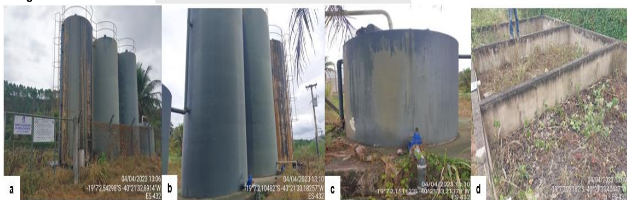
Figura 24: Registros fotográficos Ete São Jorge do Tiradentes: a) Vista da entrada da Ete; b) Uasb; c) Biofiltro; g) leito de secagem.
