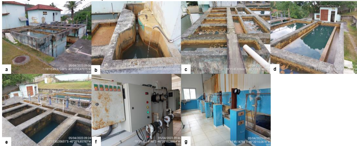
Figura 12: Vistas da ETA 1Sede: a) vista geral da eta b) calha parshall; c) floculadores; d) decantadores; e) filtros; f) sistema gerador de cloro; g) tanques de mistura.
