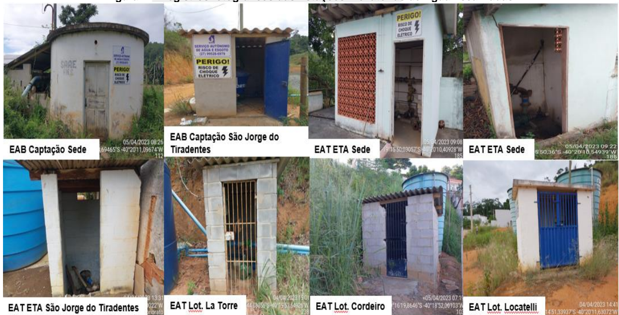
Figura 21: Registros fotográficos das Estações Elevatórias de Água fiscalizadas.
