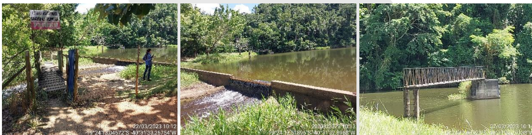
Figura 7: Registro Fotográfico da captação no Rio São Pedro
