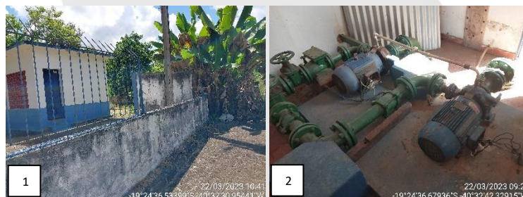
Figura 18: Registros fotográficos das Estações Elevatórias de Água fiscalizadas.
