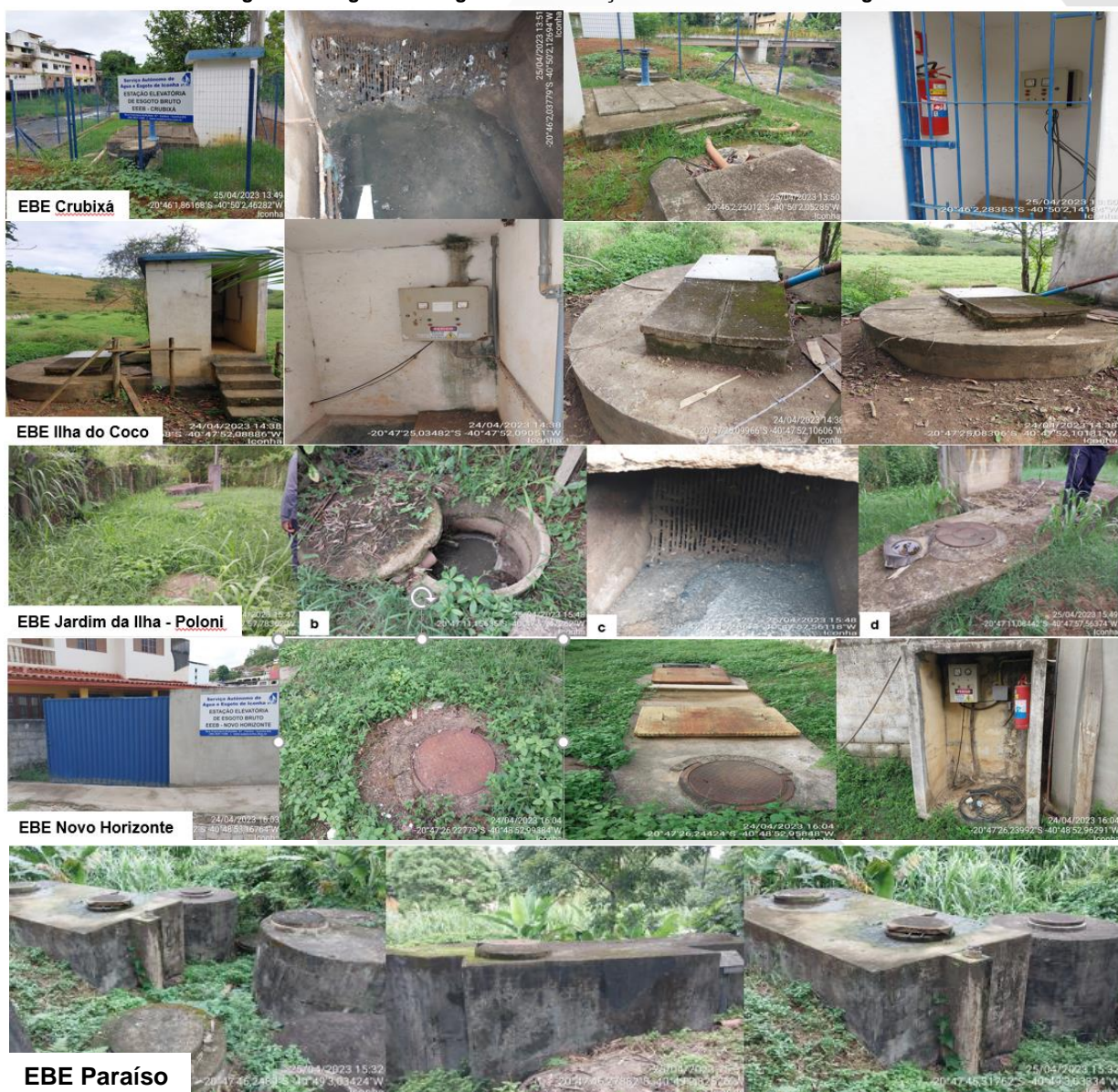
Figura 28: Registros fotográficos da Estação de bombeamento de esgoto.
