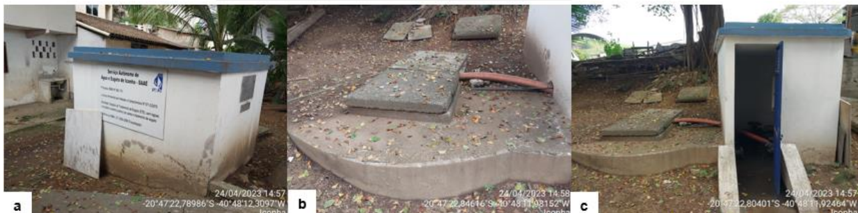
Figura 24: Registros fotográficos ETE Jardim da Ilha: a) Vista da geral da ETE; b) Unidade de tratamento; c) Casa de bombas.
