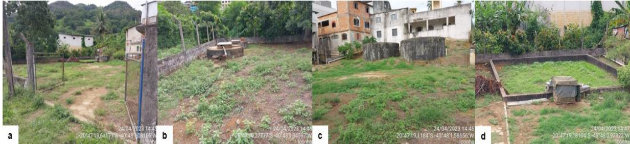
Figura 23: Registros fotográficos ETE Ilha do Coco I: a) Vista da entrada da ETE; b) Pré-Tratamento; c) Tratamento secundário; d) Leito de Secagem.
