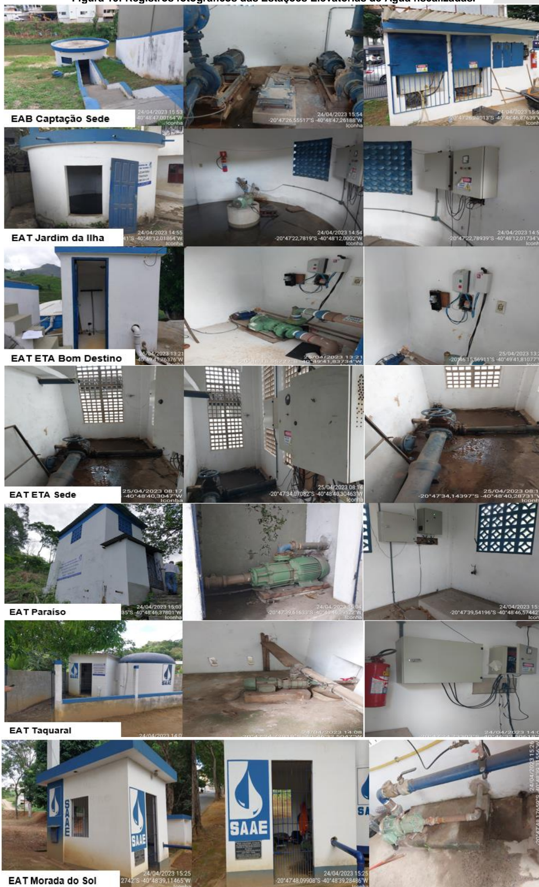
Figura 19: Registros fotográficos das Estações Elevatórias de Água fiscalizadas.
