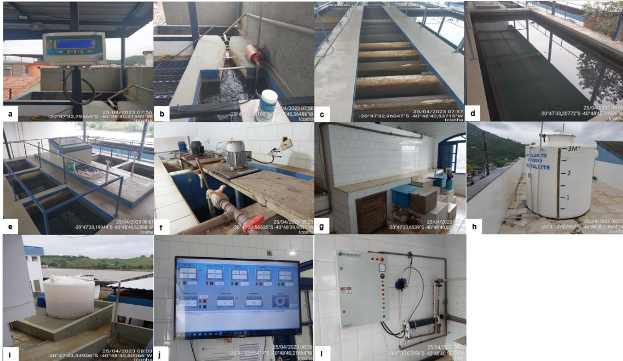
Figura 11: Vistas da ETA Sede: a) Macromedidor de vazão; b) Calha parshall; c) Floculadores; d) Decantador; e) Filtros; f) Tanque de mistura; g) Dosador de sulfato e flúor; h) Reservatório de hipoclorito de sódio; i) Reservatório de sulfato de alumínio; j) Sistema de telemetria; l) Sistema gerador de cloro.
