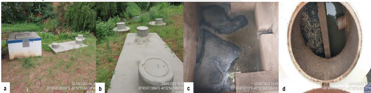
Figura 22: Registros fotográficos ETE Duas Barras: a) Vista da entrada da ETE; b) Fossa séptica e filtro anaeróbico; c) Pré-tratamento; d) Pré-tratamento.
