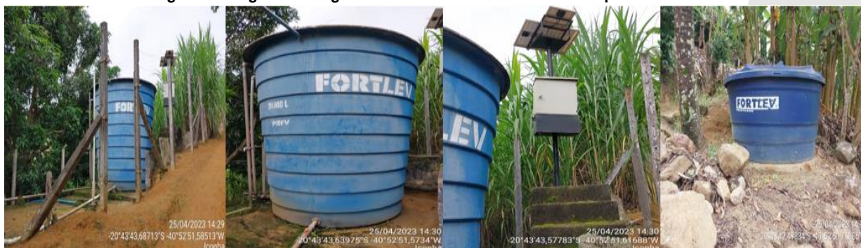
Figura 15: Registros fotográficos do sistema de tratamento simplificado de Duas Barras.
