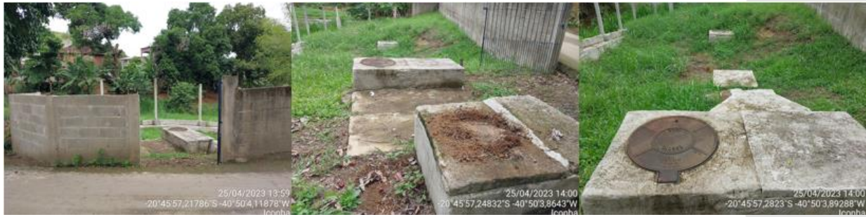
Figura 27: Registros fotográficos ETE Santo Inácio.
