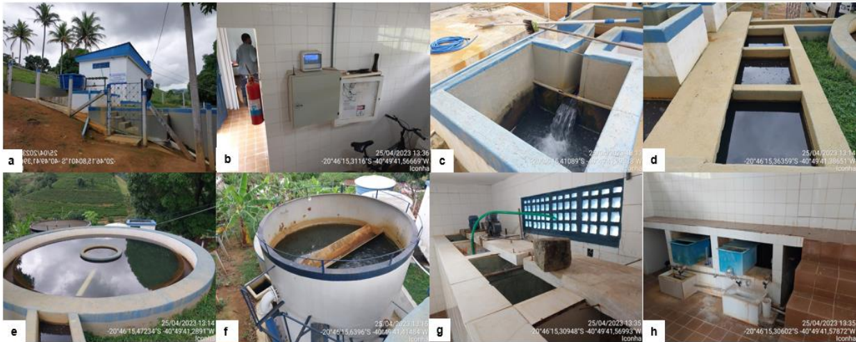
Figura 13: Vistas da ETA Bom Destino: a) Vista geral da Eta; b) Macromedidor de vazão; c) calha parshall; d) Floculadores; e) Decantador; f) Filtro; g) tanques de mistura; h) Dosador de cloro e sulfato.
