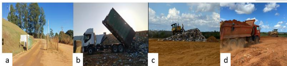
Figura 10 – Registros Fotográficos do aterro sanitário de Linhares. a) Vista da chegada do aterro; b) Vista da descarga dos resíduos; c) Vista da máquina que espalhando os resíduos; d) Vista do Caminhão com a terra para cobertura do material;
