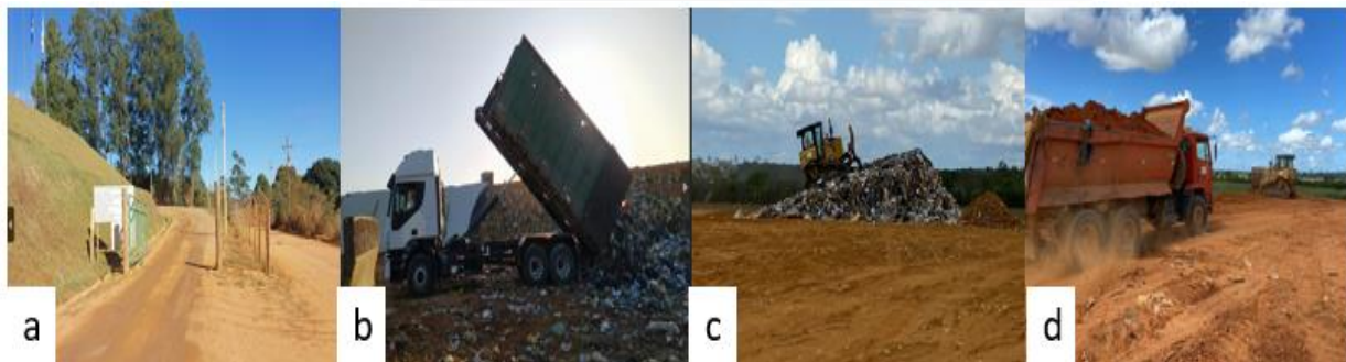
Figura 9 – Registros Fotográficos do aterro sanitário de Linhares. a) Vista da chegada do aterro; b) Vista da descarga dos resíduos; c) Vista da máquina que espalhando os resíduos; d) Vista do Caminhão com a terra para cobertura do material;
