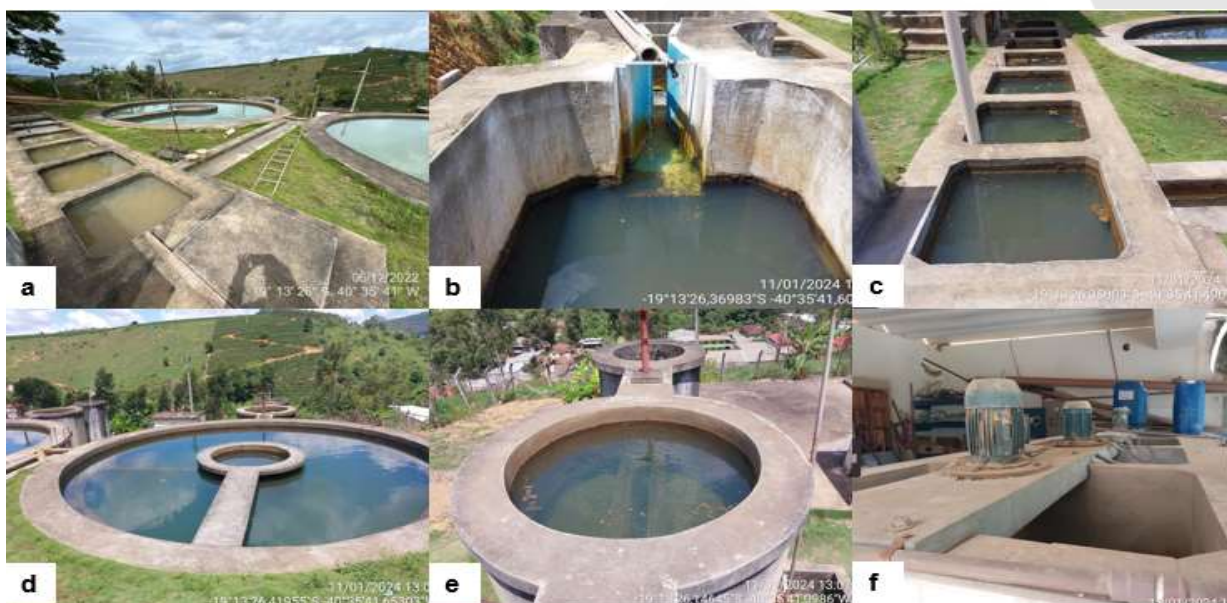
Figura 17: Vistas da ETA Novo Brasil: a) vista geral da ETA; b) Calha Parshall; c) floculadores; d) decantadores; e) filtros; f) desinfecção;
