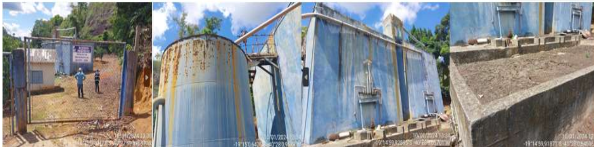
Figura 24: Registros fotográficos da ETE Sede.
