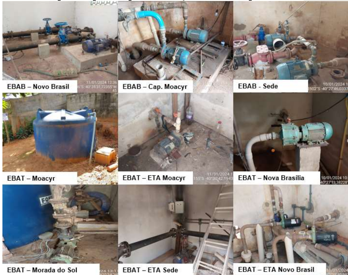
Figura 22: Registros fotográficos das Estações Elevatórias de Água fiscalizadas.
