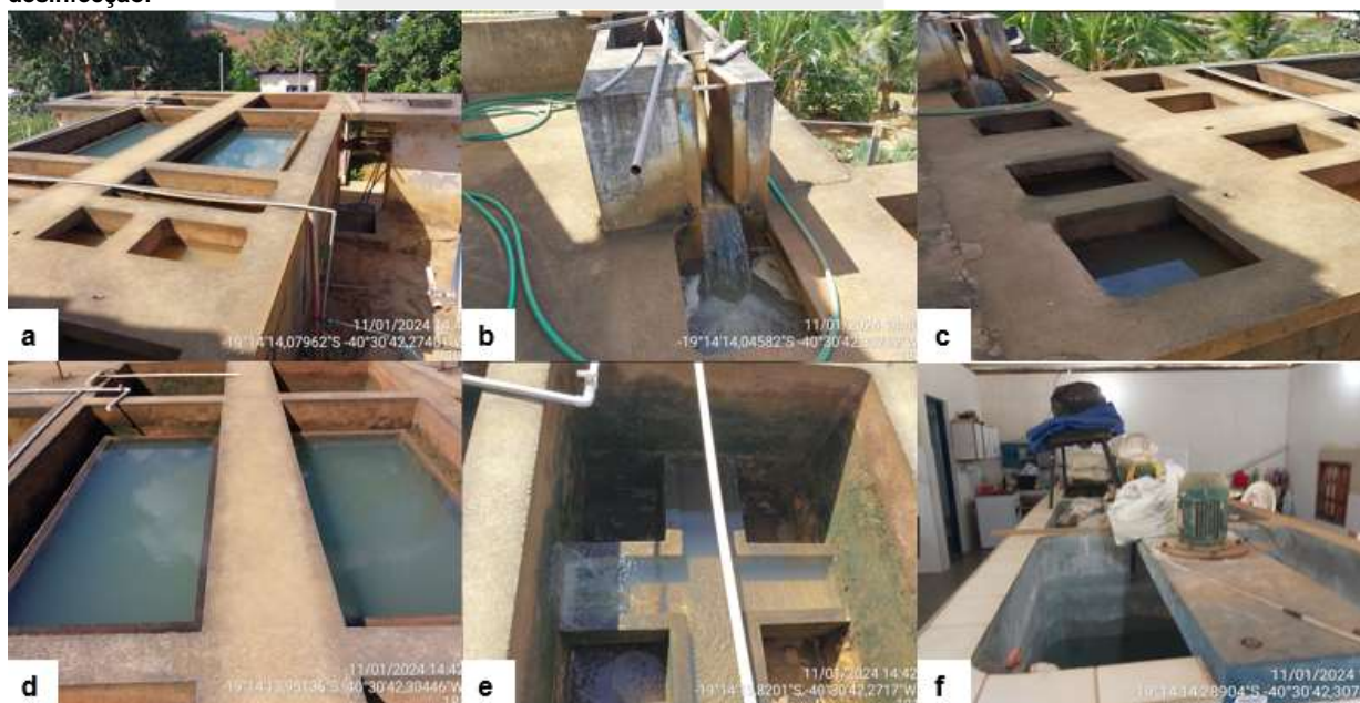
Figura 15: Vistas da ETA Moacyr: a) vista geral da ETA; b) Calha Parshall; c) floculadores; d) decantadores; e) filtros; f) desinfecção.
