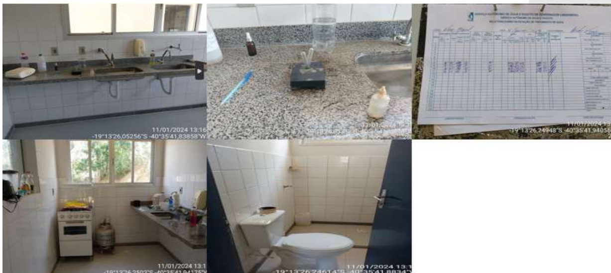
Figura 18: Registros fotográficos da área de apoio da ETA Novo Brasil.
