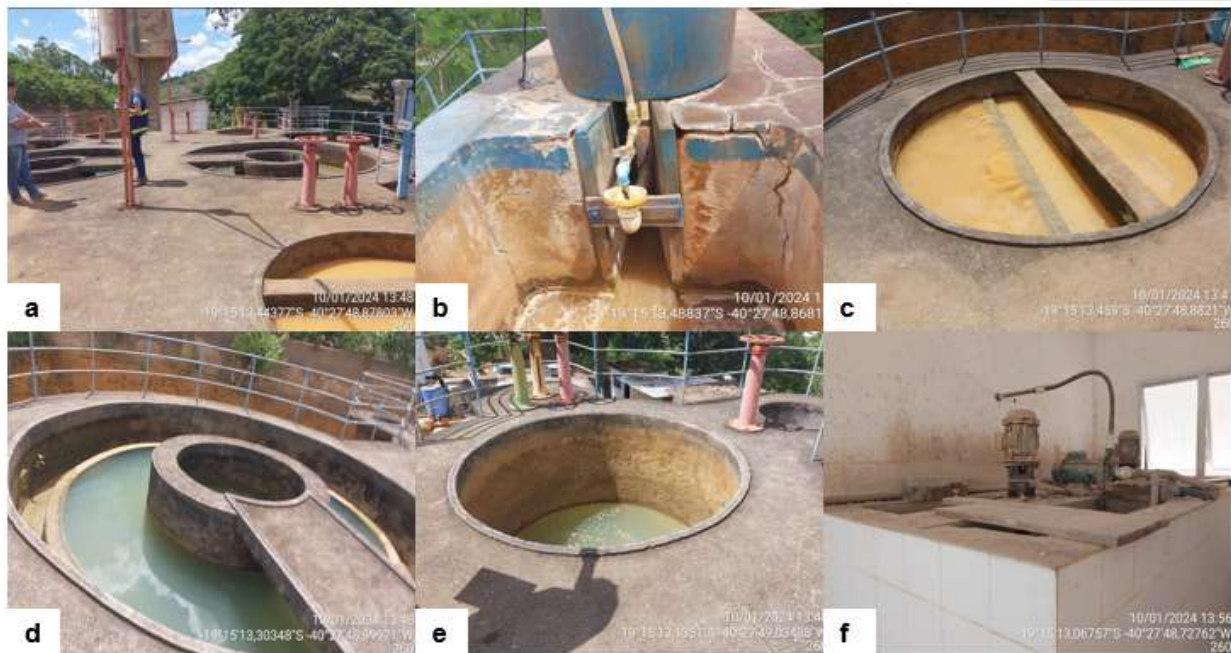
Figura 13: Vistas da ETA Sede: a) vista geral da ETA; b) Calha Parshall; c) floculadores; d) decantadores; e) filtros; f) desinfecção.
