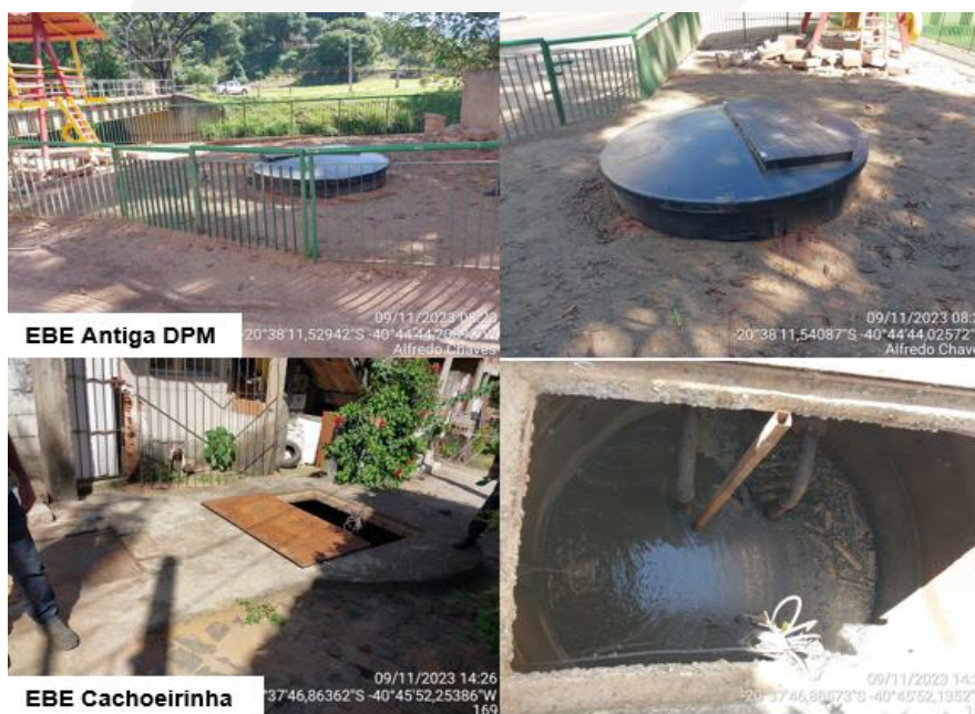
Figura 31: Registros fotográficos da Estação de bombeamento de esgoto
