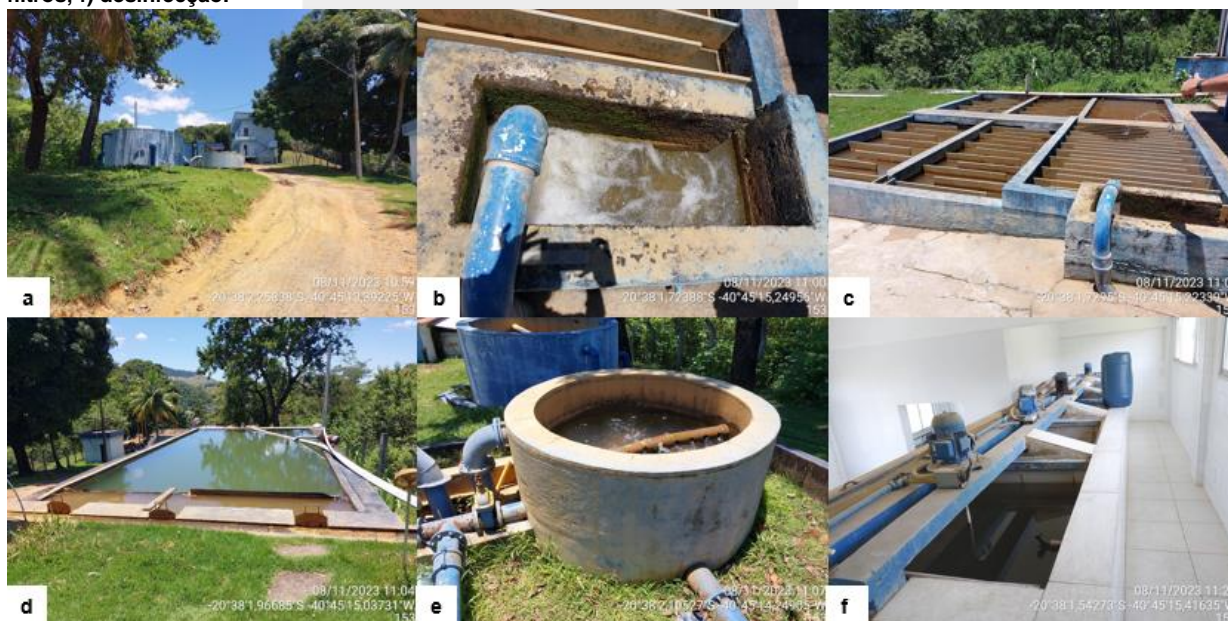
Figura 13: Vistas da ETA Sede: a) vista geral da ETA; b) chegada da água bruta; c) floculadores; d) decantadores; e) filtros; f) desinfecção.
