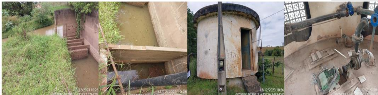
Figura 7: Registro fotográfico da captação no Rio Muqui.
