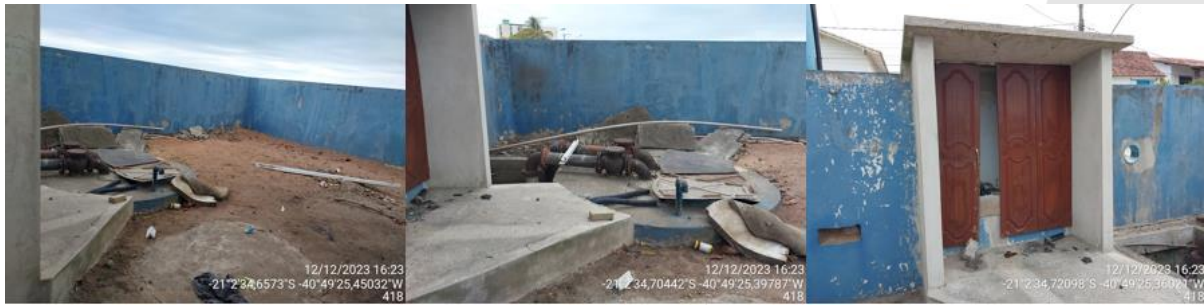
Figura 49: Registros fotográficos da Estação de bombeamento de esgoto late.
