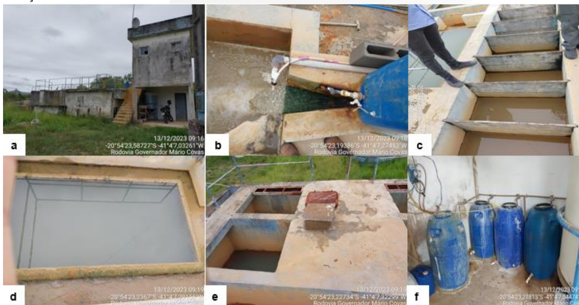
Figura 25: Vistas da ETA Luanda: a) vista geral da ETA; b) Calha Parshall; c) floculadores; d) decantadores; e) filtros; f) desinfecção.
