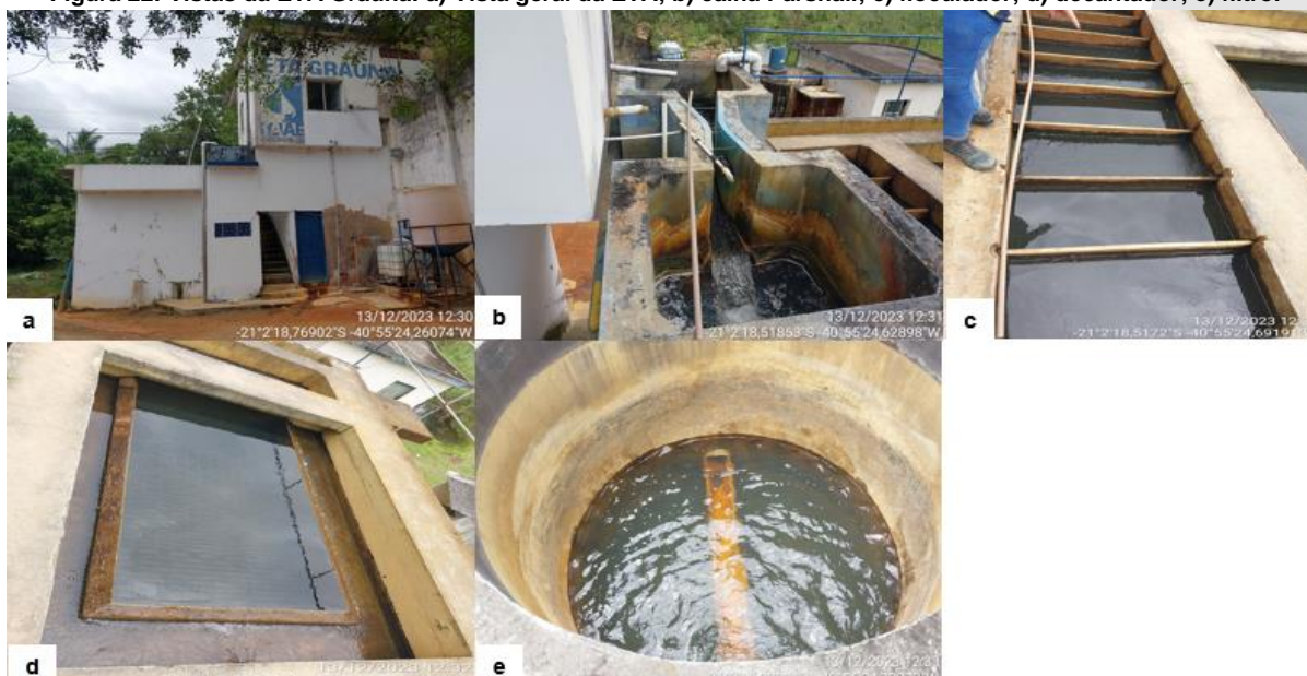
Figura 22: Vistas da ETA Graúna: a) Vista geral da ETA; b) calha Parshall; c) floculador; d) decantador; e) filtro.
