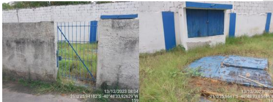
Figura 44: Registros fotográficos da Estação de bombeamento de esgoto Coronel Soares.
