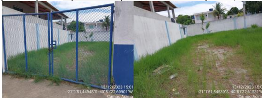
Figura 40: Registros fotográficos da Estação de bombeamento de esgoto Campo Acima III.
