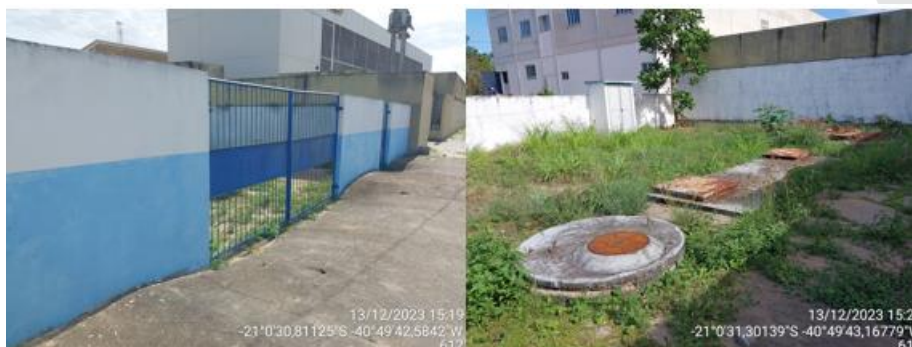
Figura 57: Registros fotográficos da Estação de bombeamento de esgoto Serramar.
