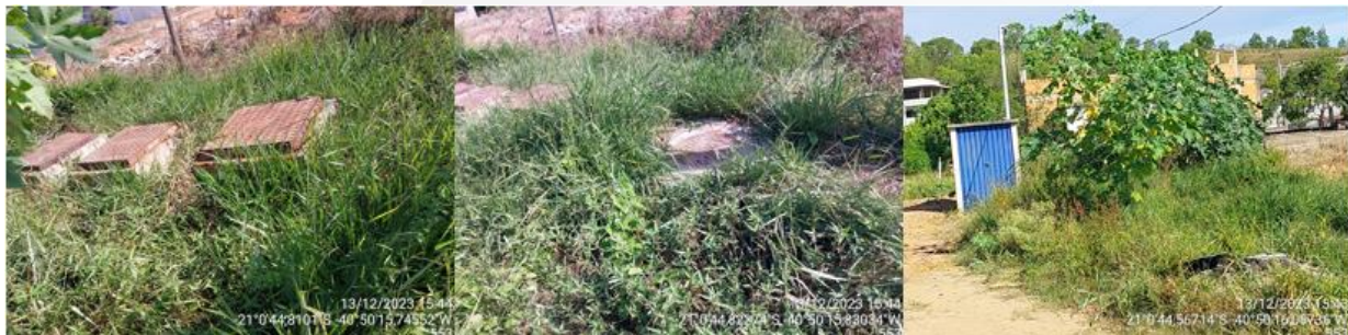
Figura 50: Registros fotográficos da Estação de bombeamento de esgoto Jardim Paulista.
