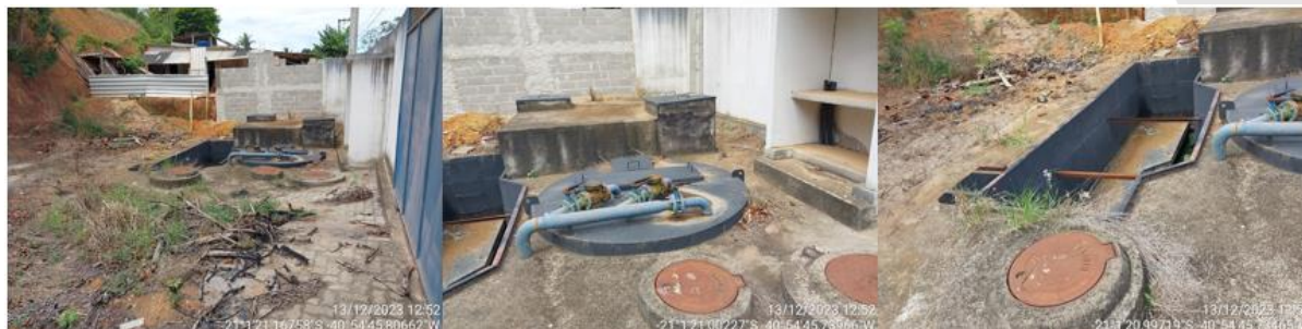
Figura 47: Registros fotográficos da Estação de bombeamento de esgoto Graúna II.
