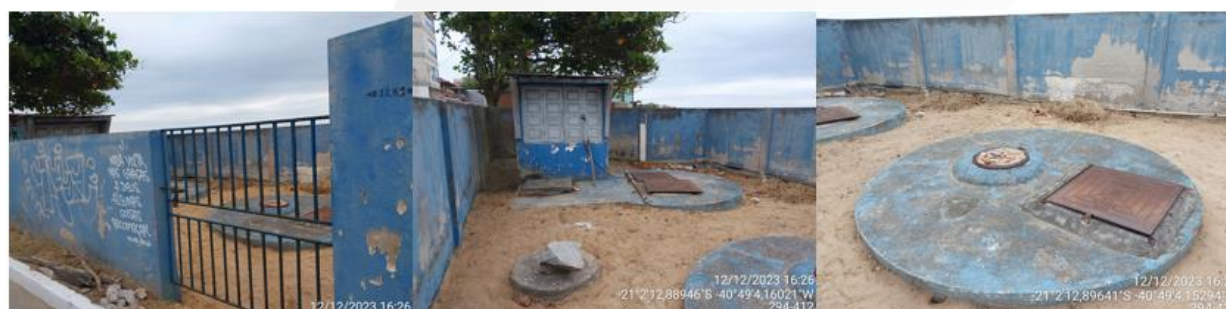
Figura 55: Registros fotográficos da Estação de bombeamento de esgoto Vitória.
