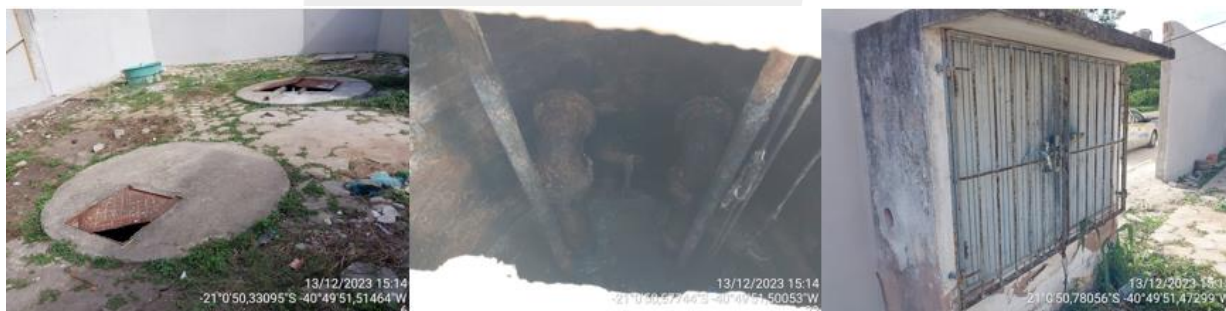
Figura 53: Registros fotográficos da Estação de bombeamento de esgoto Rosa Meireles.
