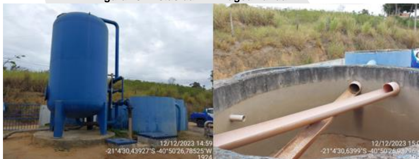
Figura 28: Vistas da ETA Lagoa Funda
