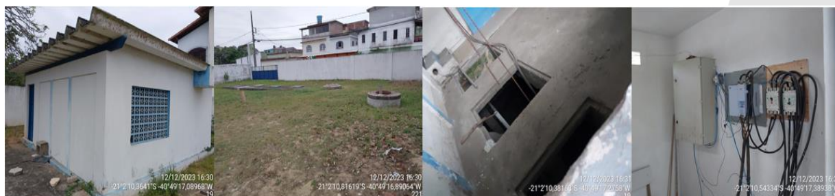
Figura 54: Registros fotográficos da Estação de bombeamento de esgoto Acre.
