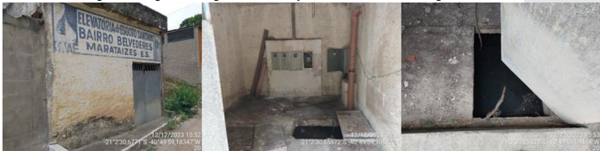
Figura 39: Registros fotográficos da Estação de bombeamento de esgoto Belvedere.
