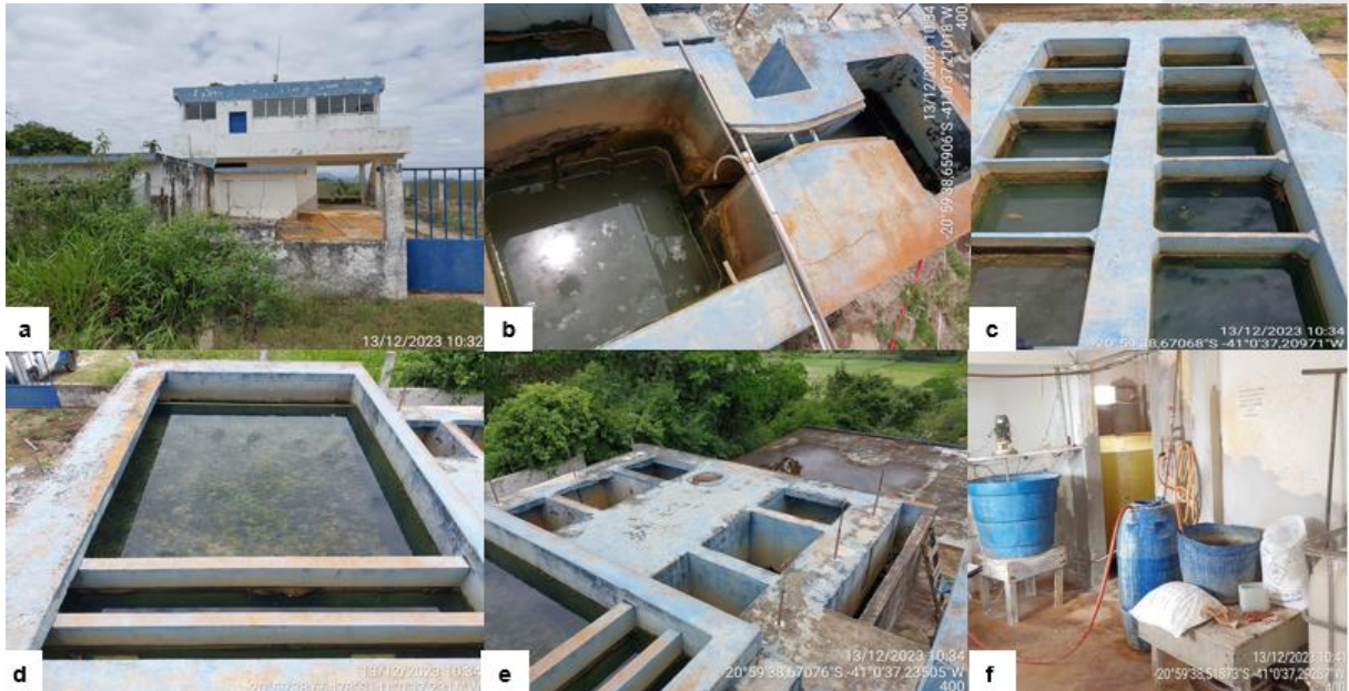
Figura 18: Vistas da ETA Garrafão: a) vista geral da ETA; b) Calha Parshall; c) floculadores; d) decantadores; e) filtros; f) desinfecção.
