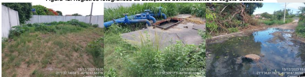
Figura 42: Registros fotográficos da Estação de bombeamento de esgoto Candeus.
