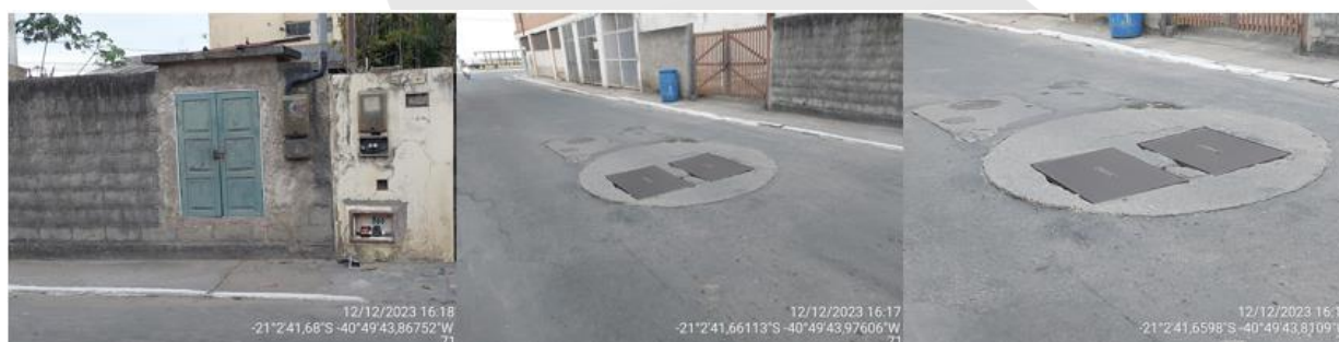
Figura 56: Registros fotográficos da Estação de bombeamento de esgoto Sal e Mel.
