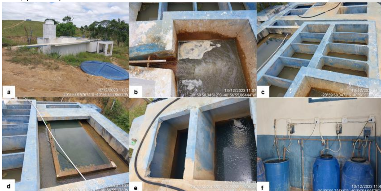
Figura 27: Vistas da ETA Pedra Rio Muqui: a) vista geral da ETA; b) Calha Parshall; c) floculadores; d) decantadores; e) filtros; f) desinfecção.
