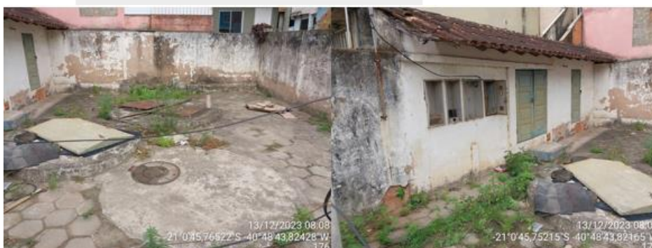
Figura 58: Registros fotográficos da Estação de bombeamento de esgoto Thomé de Souza.
