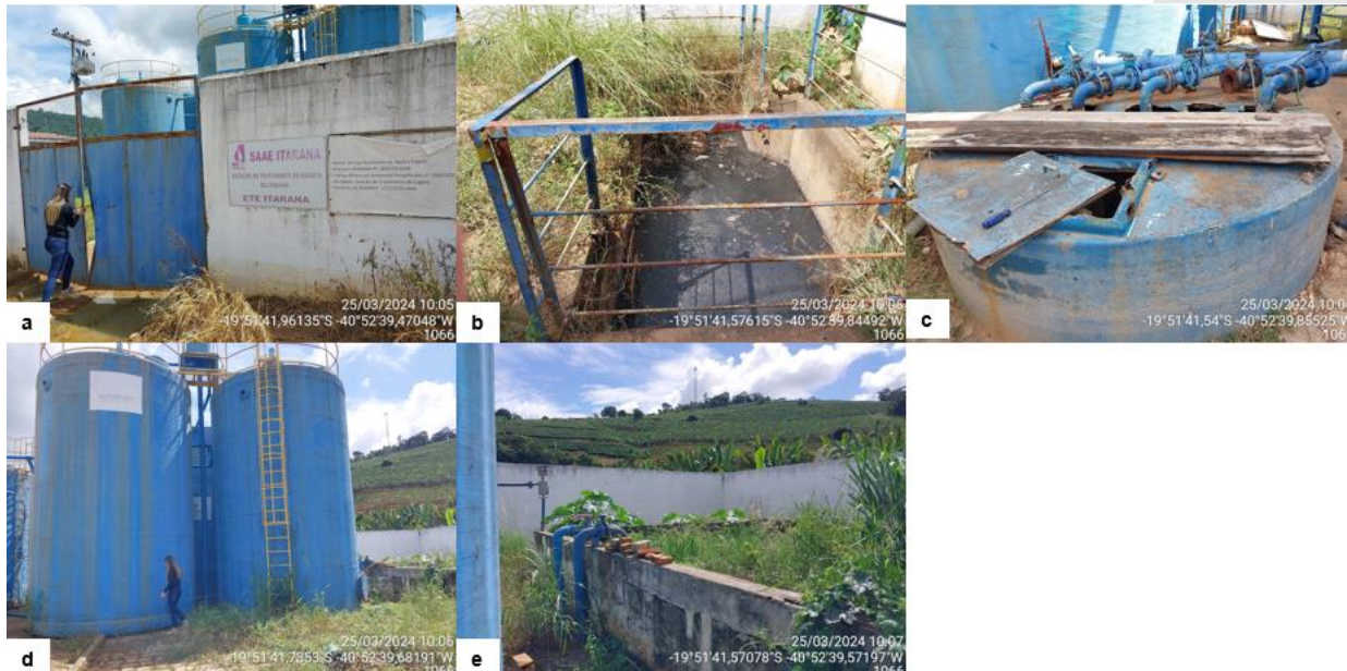
Figura 25: Registros fotográficos ETE Sede: a) Vista da entrada da ETE; b) Tratamento primário; c) Bombeamento; d) UASB; e) Leito de secagem.
