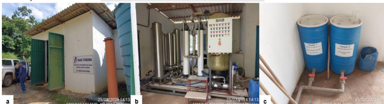
Figura 16: Vistas da ETA Limoeiro Santo Antônio: a) vista frontal da eta; b) sistema compacto de filtração; c) área de desinfecção.
