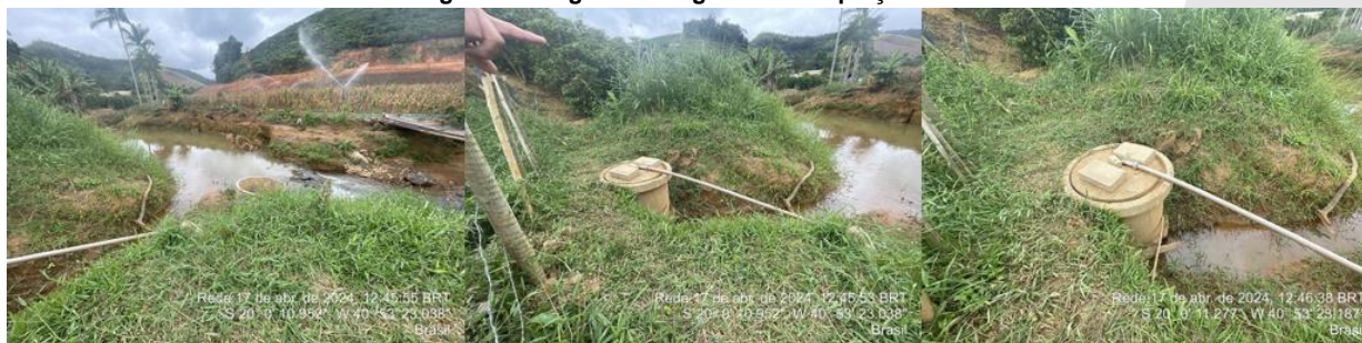
Figura 10: Registro Fotográfico da captação Rio Limoeiro
