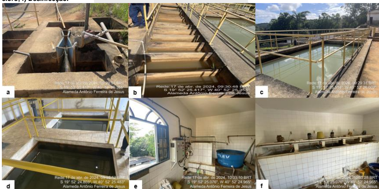
Figura 12: Vistas da ETA Sede: a) Calha parshall; b) Floculadores; c) Decantadores; d) Filtros; e) Tanque de gerador de cloro; f) Desinfecção.
