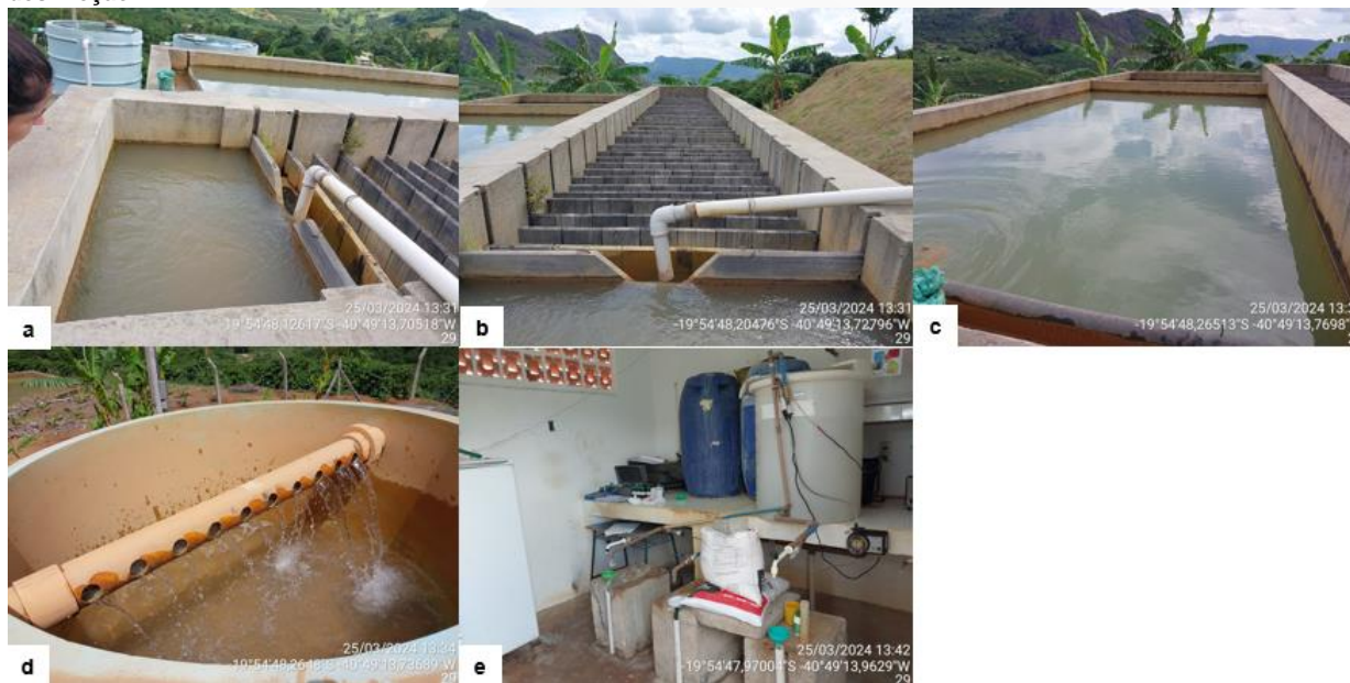
Figura 14: Vistas da ETA Caravagio: a) Vertedouro; b) Floculador; c) Decantadores; d) Filtro rápido; e) Área de desinfecção.
