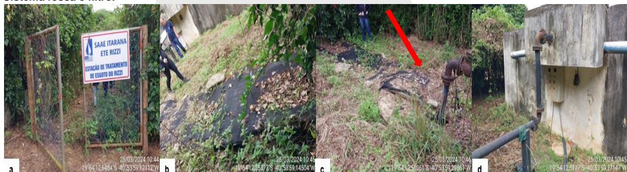
Figura 26: Registros Fotográficos ETE Rizzi: a) Vista da Entrada da ETE; b) Tratamento primário; c) Poço sucção; d) Sistema fossa e filtro.
