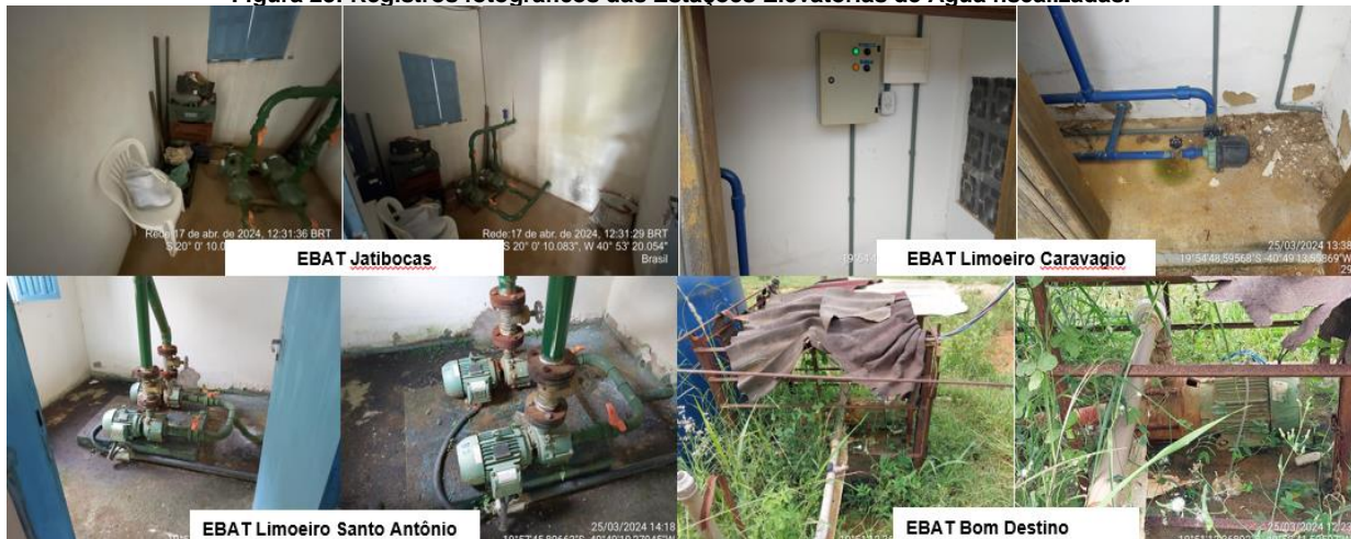
Figura 23: Registros fotográficos das Estações Elevatórias de Água fiscalizadas.
