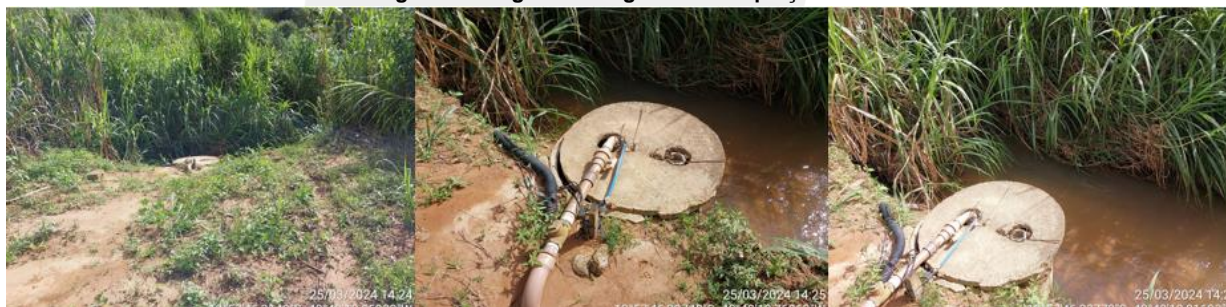
Figura 10: Registro Fotográfico da captação Rio Limoeiro
