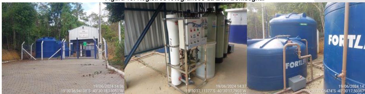
Figura 15: Registros fotográficos da ETA Bonisegna.
