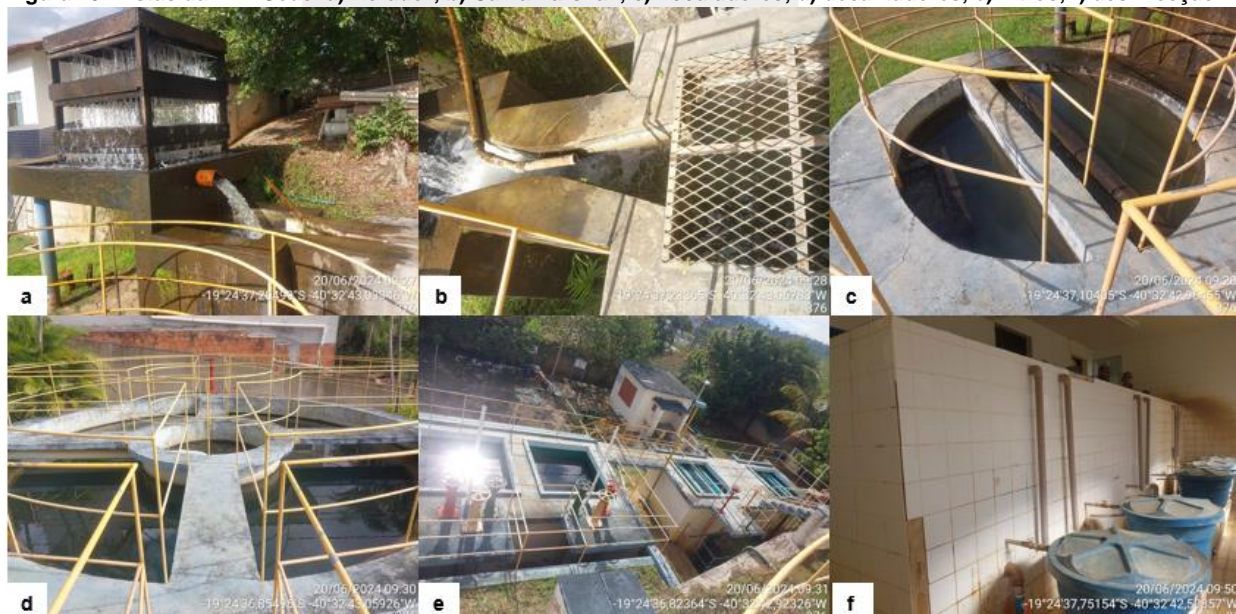
Figura 10: Vistas da ETA Sede: a) Aerador; b) Calha Parshall; c) floculadores; d) decantadores; e) filtros; f) desinfecção.
