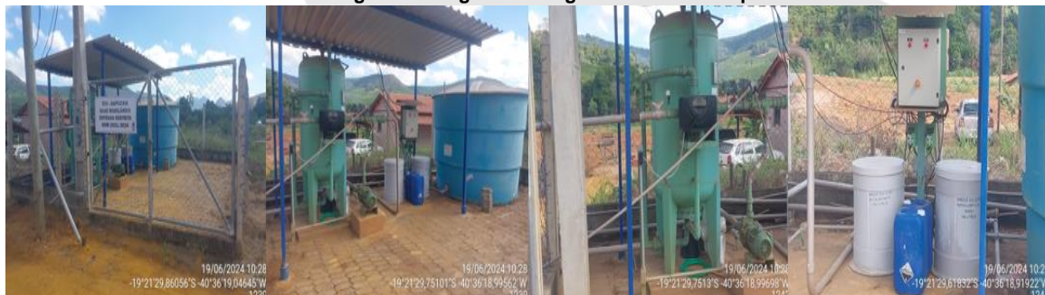
Figura 12: Registros fotográficos da ETA Sapucaia.
