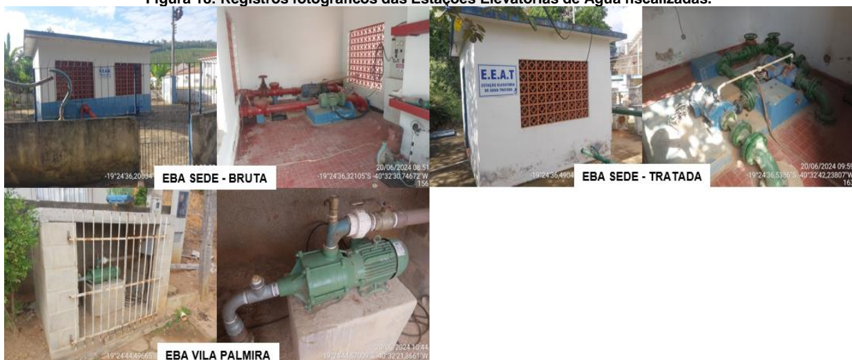
Figura 18: Registros fotográficos das Estações Elevatórias de Água fiscalizadas.
